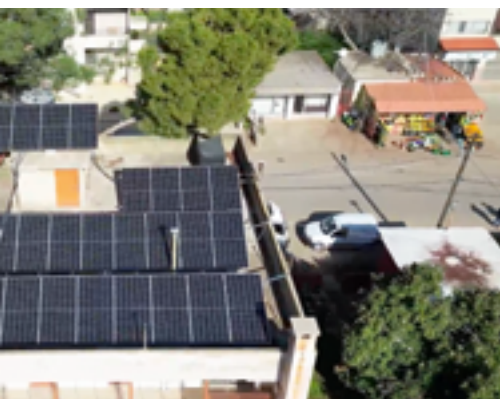
Solarpanels und Stromspeicher
