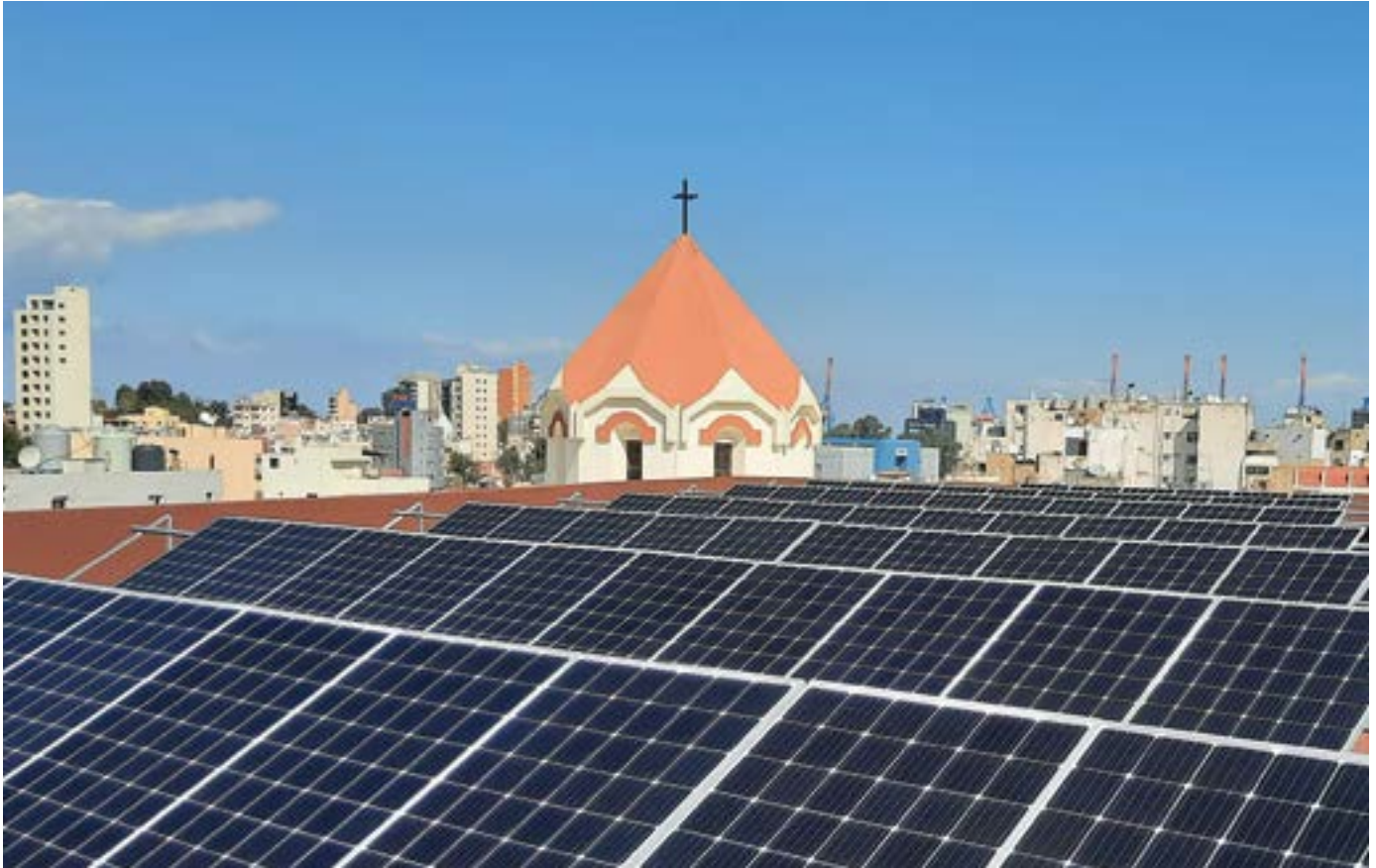
Solaranlage in Nor Marash, Beirut
